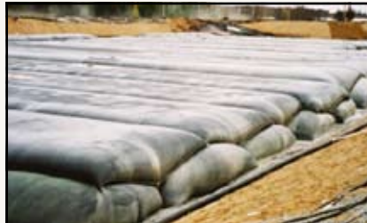
Contenedores Geotube® en una pila de lodos activados en una fábrica de papel.
