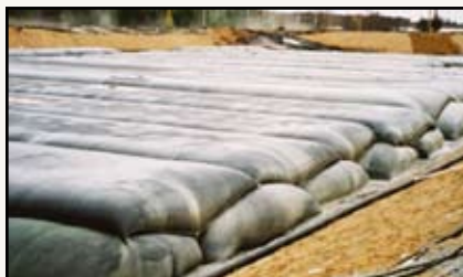
GEOTUBE® dans un bassin de boues générées par une papeterie.
