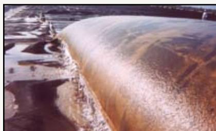
Effluent venant d'un système GEOTUBE®.
